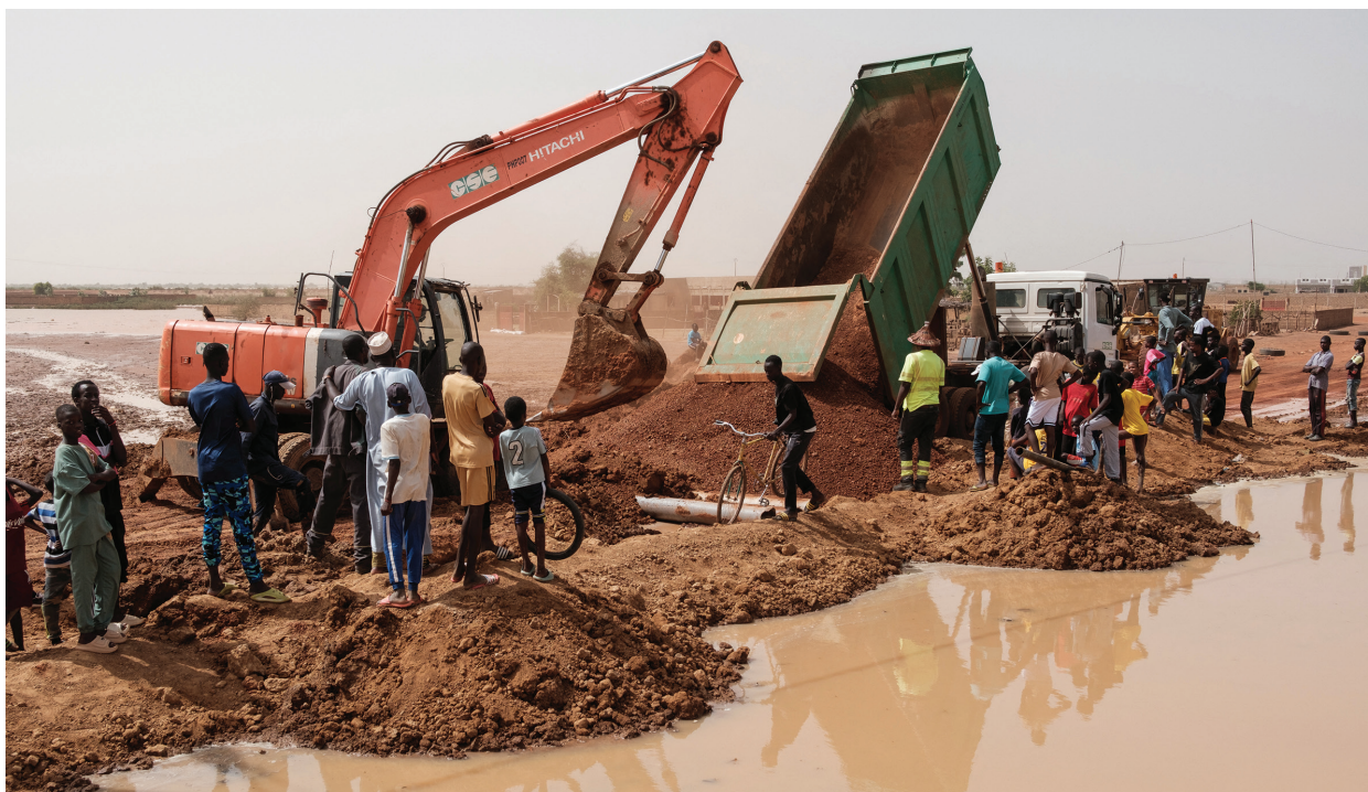
Une équipe de volontaires déverse de la terre pour construire un barrage et reconstruire une route principale détruite lors d'importantes inondations au Sénégal, le 21 octobre 2024. (Photo : AFP/GUY PETERSON)
